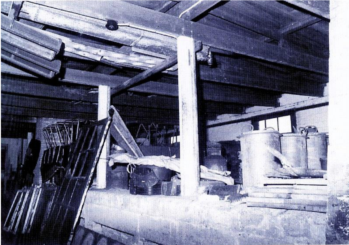
Op de kaaszolder. Rechts op de verhoging Swartzz-vaten. Voorts: koelvaten, melkbussen, kaasplanken voor Edammers, ijszagen, melkgoten, en overtollige ramen en luiken. Aangetroffen situatie 1984
